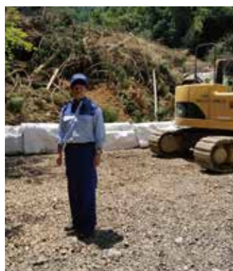
台風20号の被害を調査 大江福知山の崖崩れ
